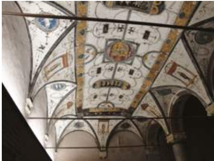
2. Stato attuale della volta della loggia Stati Mattei.
